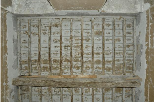
Cassettone prima del restauro
